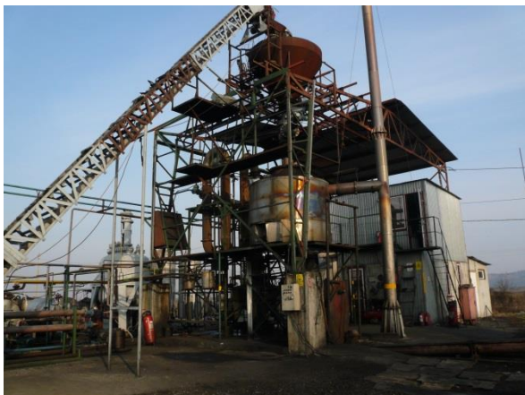
BATCH-ANLAGE IN UNGARN
