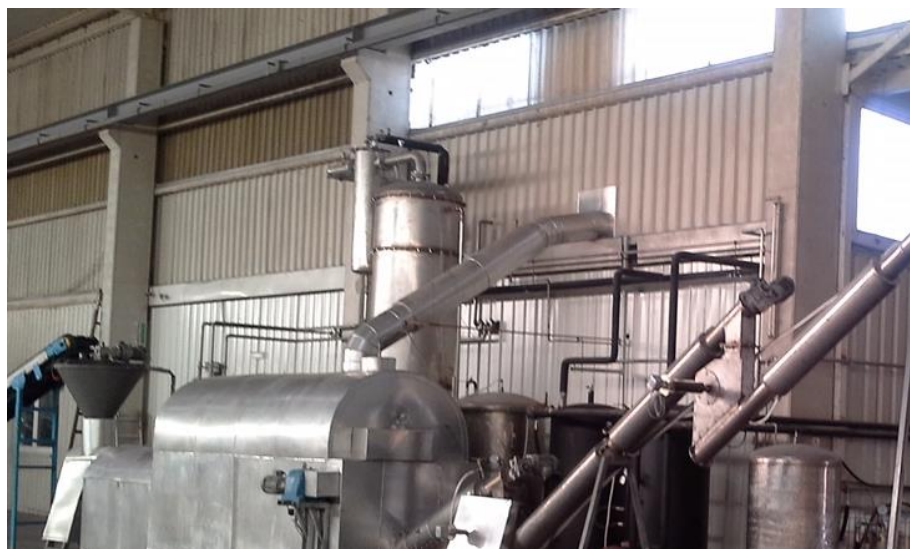
TEILANSICHT DER PILOTANLAGE (2012)
